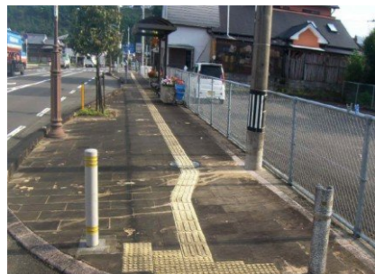
汚れたインターロッキングブロック
